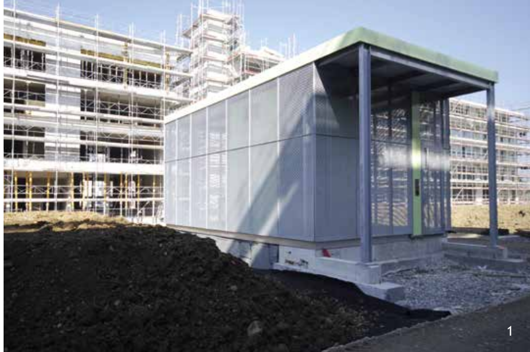
1 à 3. Les premiers logements sont bientôt terminés. L'ensemble du quartier sera achevé en 2018.
